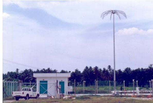
Fig. 7. Disipador en forma de paraguas para protección de una instalación de gas. Cortesía de Hartono [14].
